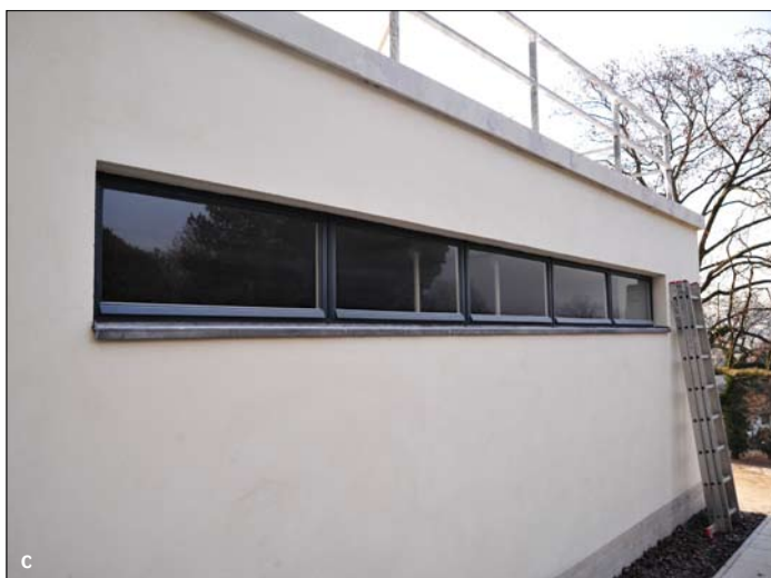
Obr. 24: Brno, Černopolská 45, vila Tugendhat: a, b – pásové ventilační okno pod salla terenou bylo zcela zničeno poklesem terasy a korozí povrchovou i spárovou. Některé prvky zcela chyběly. Při tak rozsáhlém poškození není možné provést opravu na místě. Je nutno vyjmout i zažděný rám, důsledně celou konstrukci opravit, doplnit chybějící části, ošetřit proti korozi a natřít. Nezachovaly se ani fragmenty původních nátěrů. c – stav po opravě.
