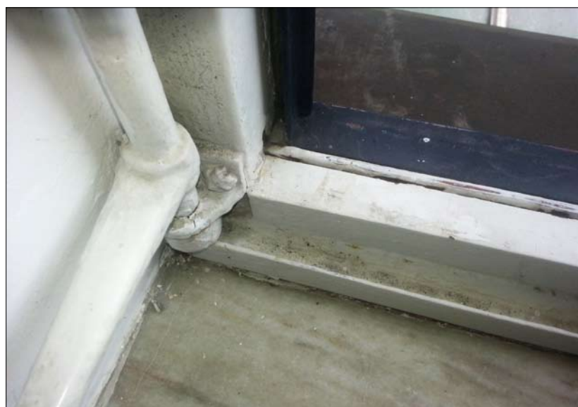
Obr. 5: Brno, Lipová 17, Žáčkova vila. Kondenzační žlábek.
