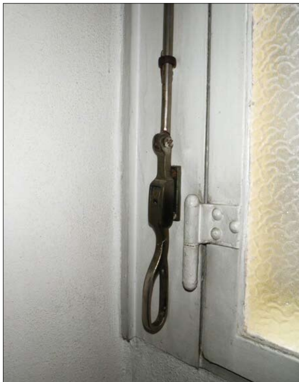
Obr. 27 a: Brno, Hroznová 14, vila Stiassni. Detail okenního rámu s ovládací pákou ventilačního křídla. Ocelové části i páka se dochovaly ve velice dobrém stavu včetně původního nátěru.
