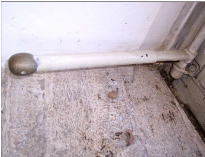
Obr. 22: Brno, Tomešova 4a, Kyselkova vila. Ovládací páka uzamykacího mechanismu okna, kde je vidět sice funkční, ale naprosto neodborná oprava. Zlomená páka byla nadstavena trubkou. Ulomená část byla naražena do trubky tak, že se zachovala koule z tzv. bílé mosazi. Po mechanickém zprovoznění okna byla páka repasována.
